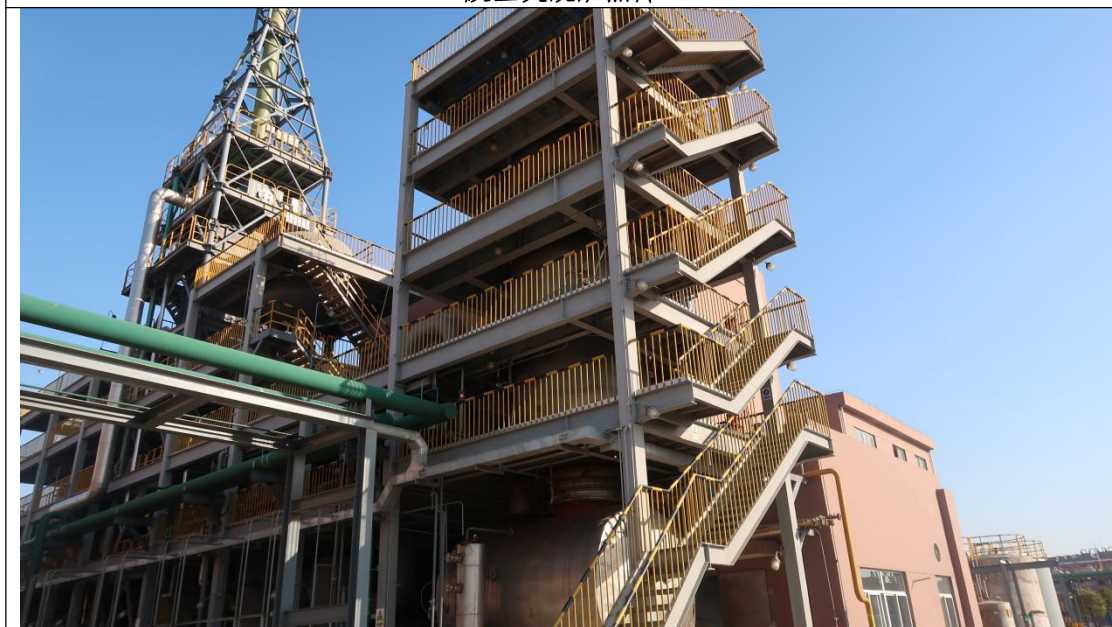
液中焚烧炉照片
