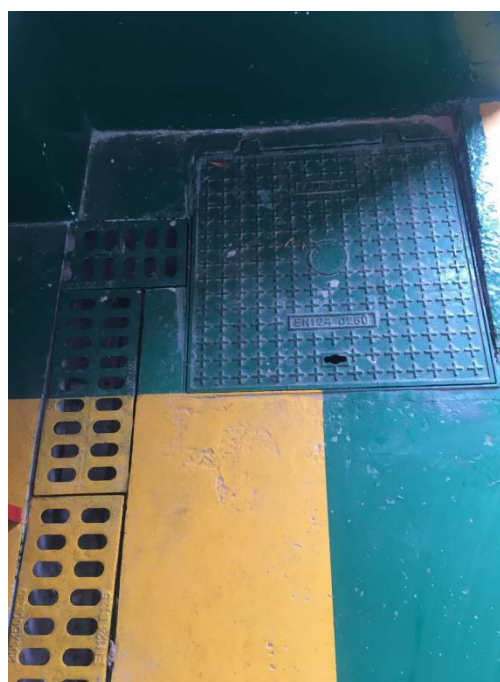
362 危废仓库收集池
