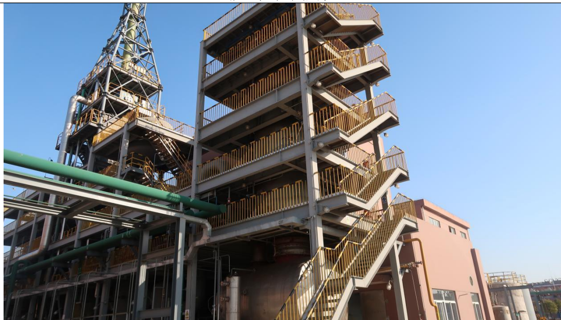
液中焚烧炉照片
