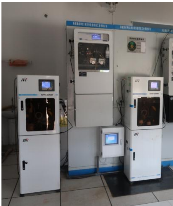
废水总排口-pH 在线
