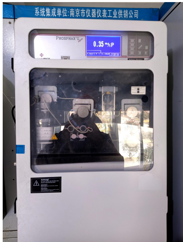
废水总排口-总磷在线
