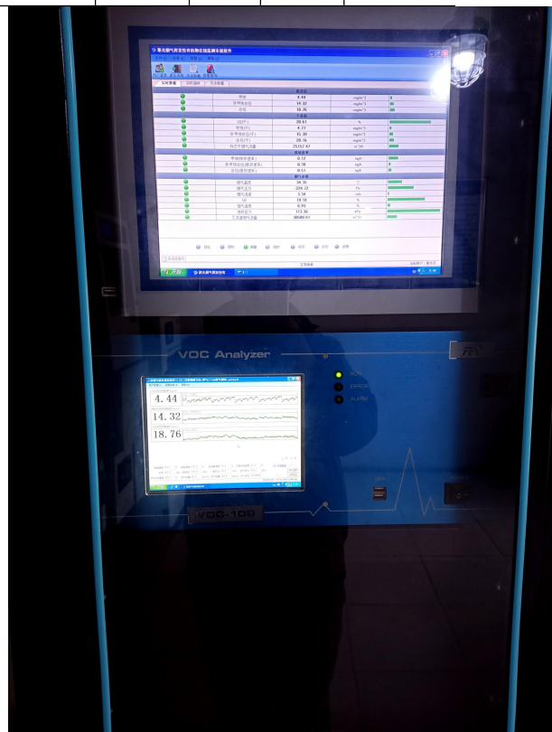
4#RTO 焚烧炉系统在线非甲烷总烃
