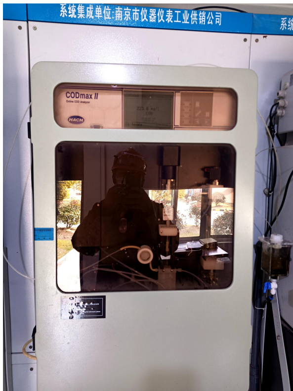
废水总排口-COD 在线
