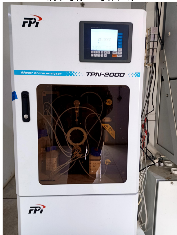
废水总排口-总氮在线
