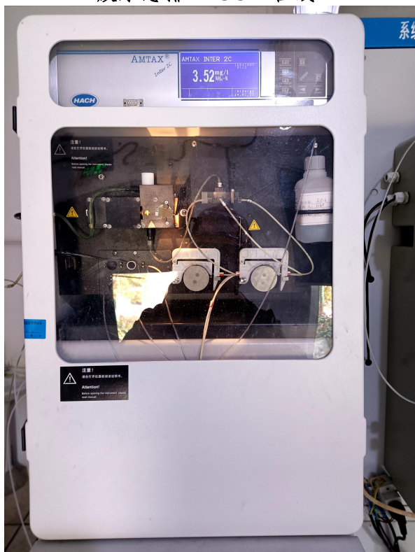
废水总排口-氨氮在线
