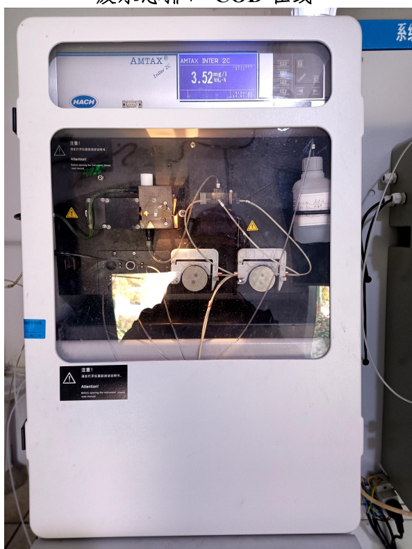
废水总排口-氨氮在线
