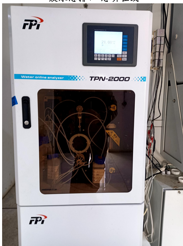
废水总排口-总氮在线
