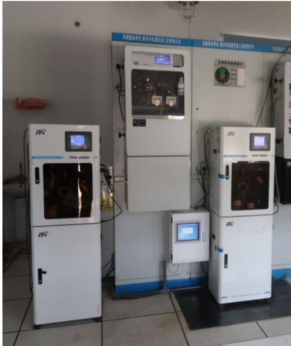
废水总排口-pH 在线
