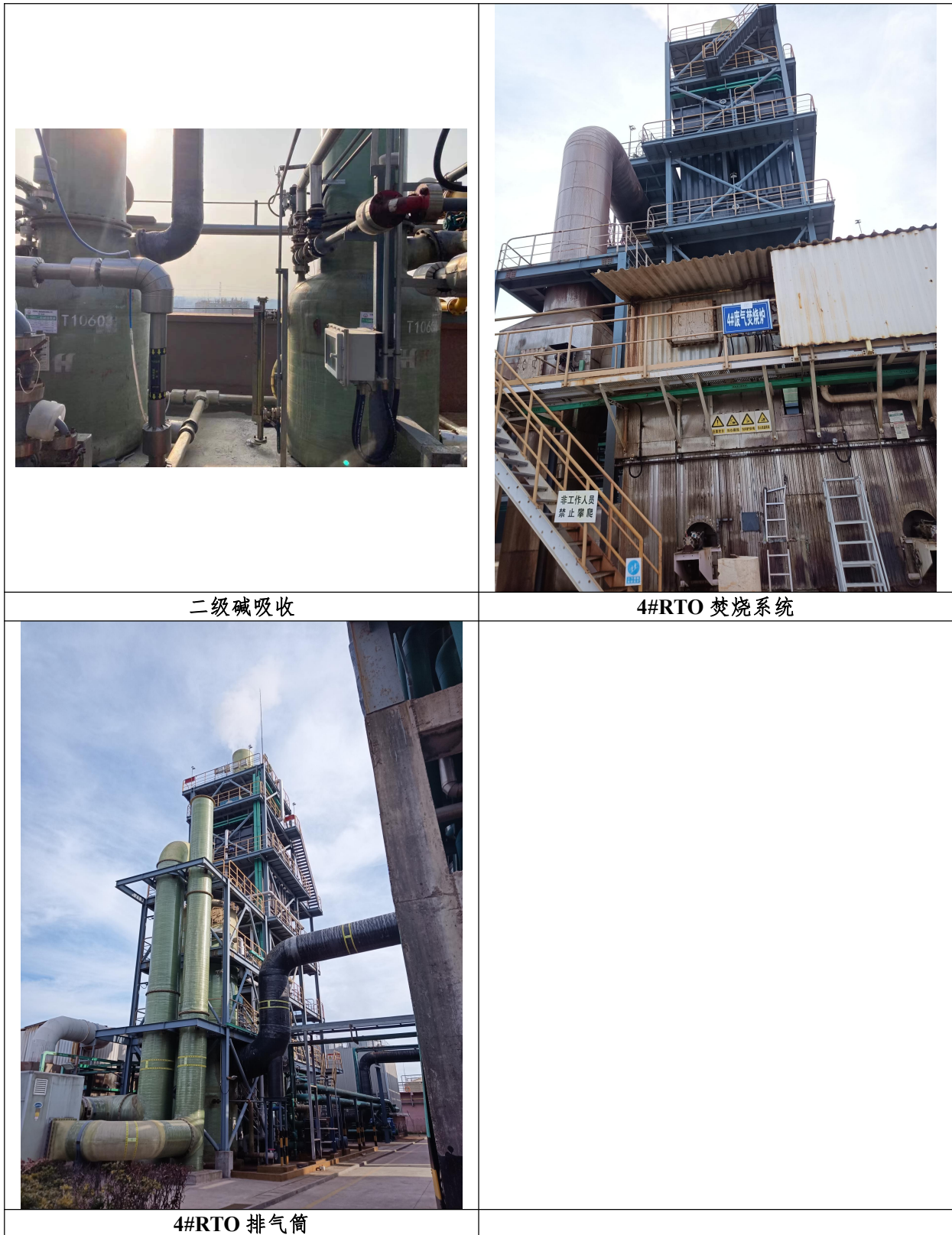
图 4.1.2-2 废气治理设施图片
