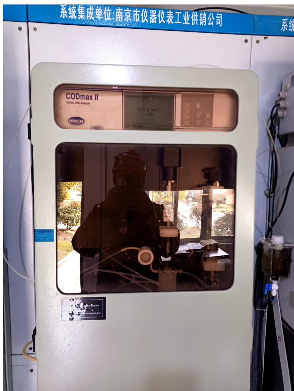
废水总排口-COD 在线
