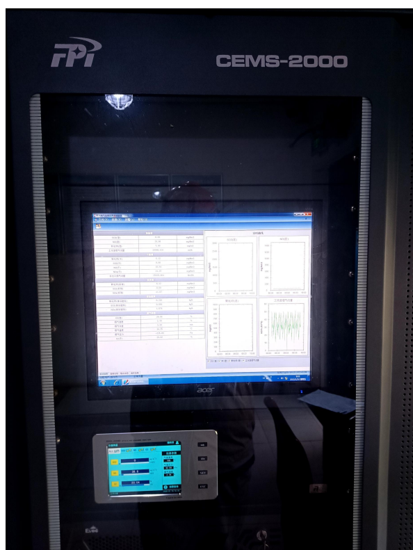
4#RTO 焚烧炉系统在线 CEMS
